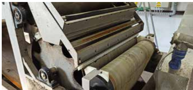
Wyremontowana prasa do odwadniania osadów
