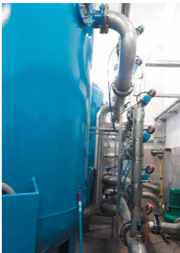
Część technologiczna stacji uzdatniania wody przy ulicy Janka z Czarnkowa w Wieleniu
