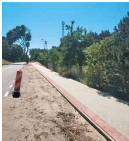
Prace związane z przebudową odcinka chodnika przy drodze wojewódzkiej na ulicy Jana Pawła II w Wieleniu
