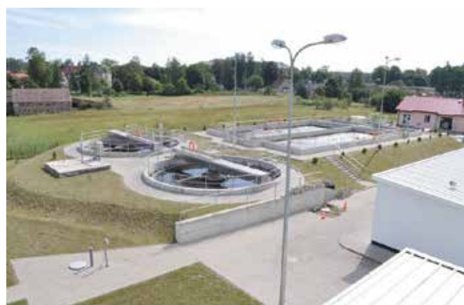
Oczyszczalnia ścieków w Wieleń, ul. Jaryńska
