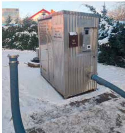
Wymieniono szafę zlewcą przy ul. Jaryńskiej w Wieleń. Koszt ok. 49 tys. zł
