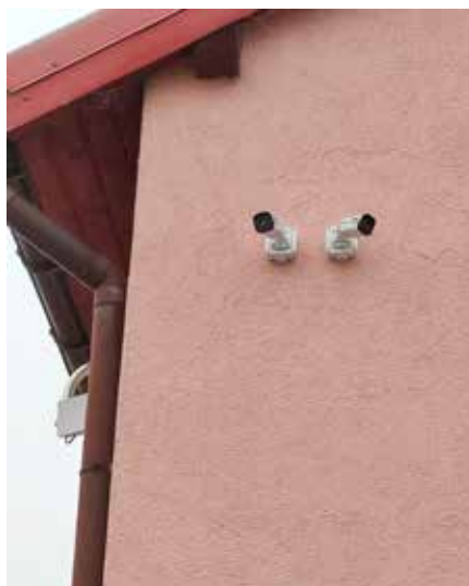
Zamontowano monitoring na oczyszczalni ścieków w Wieleń (2022). Koszt ok. 7 tys. zł
