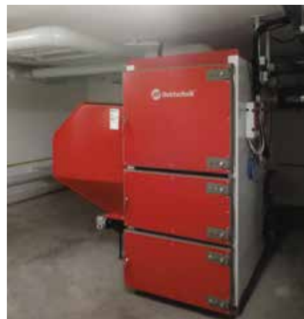
Kotłownia w Szkole Podstawowej Nr 2 w Wieleniu
