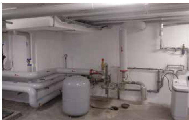
Kotłownia w Szkole Podstawowej Nr 2 w Wieleniu
