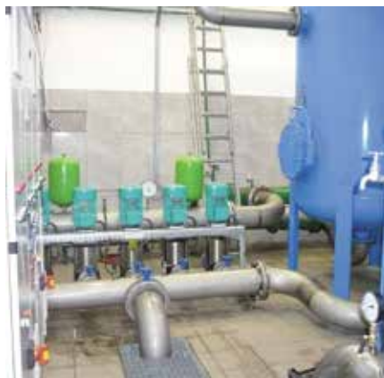
Modernizacja stacji uzdatniania wody przy ul. Janka z Czarnkowa w Wieleniu (inwestycja gminna). Przebudowa hydroforni i systemu sterowania wraz z uzdatnianiem wody (2018). Koszt ok. 1,6 mln zł
