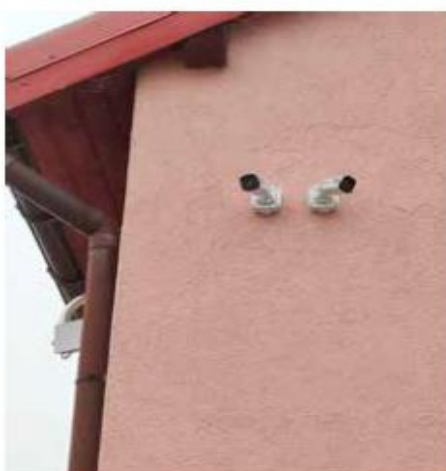
Zamontowano monitoring na oczyszczalni ścieków w Wieleniu (2022 r.) Koszt ok. 7 tys.
