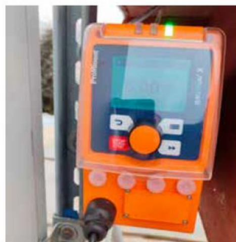
Pompa dozująca środki do uzdatniania ścieków (2022 r.). Koszt zakupu ok. 6 tys. zł
