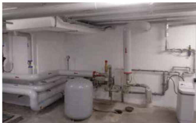
Kotłownia w Szkole Podstawowej Nr 2 w Wielki
