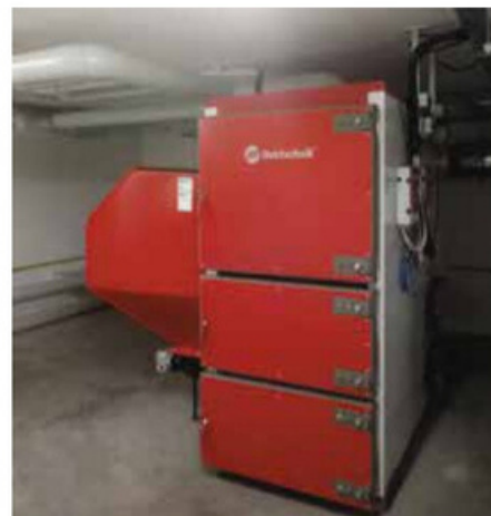
Kotłownia w Szkole Podstawowej Nr 2 w Wieleniu
