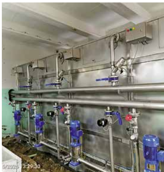
Nowe urządzenia do uzdatniania wody
